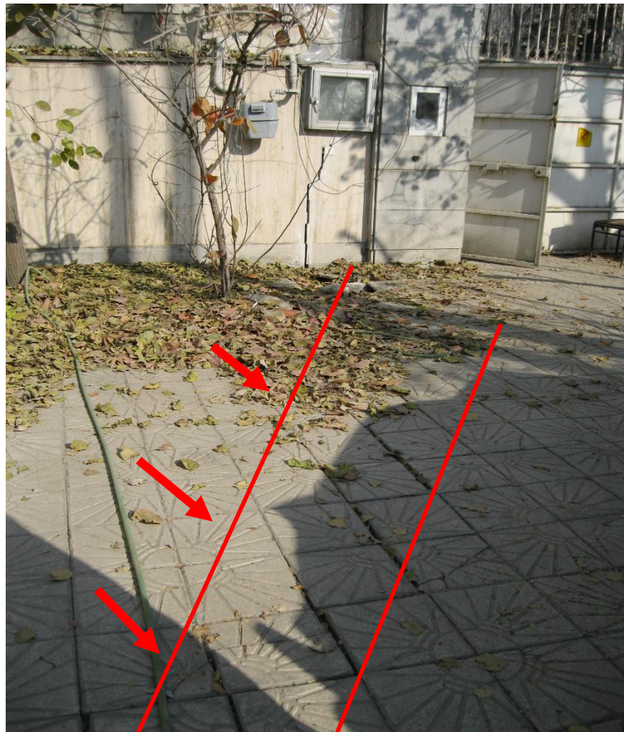
تصویر شماره 15 - ترک ایجاد شده در موزائیک کف حیاط ، در اثر گودبرداری در نزدیکی ساختمان
