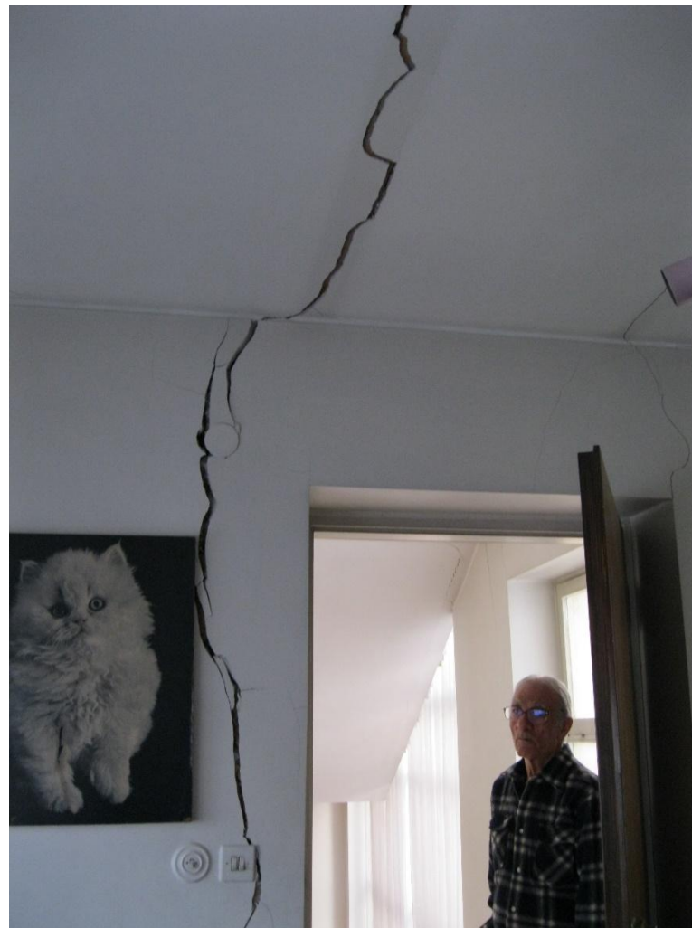
تصویر شماره 17 - ترک در دیوار و سقف ساختمان، در اثر گودبرداری در ملک مجاور
