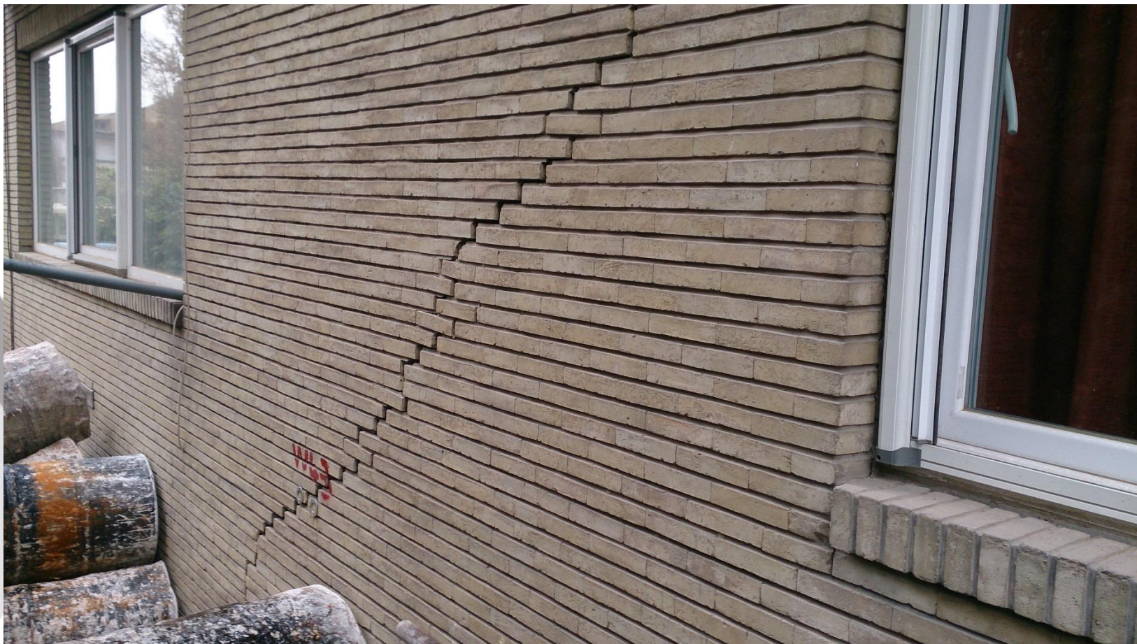
تصویر شماره 13 - ترک ایجاد شده در دیوار ، در اثر گود برداری در نزدیکی ساختمان
