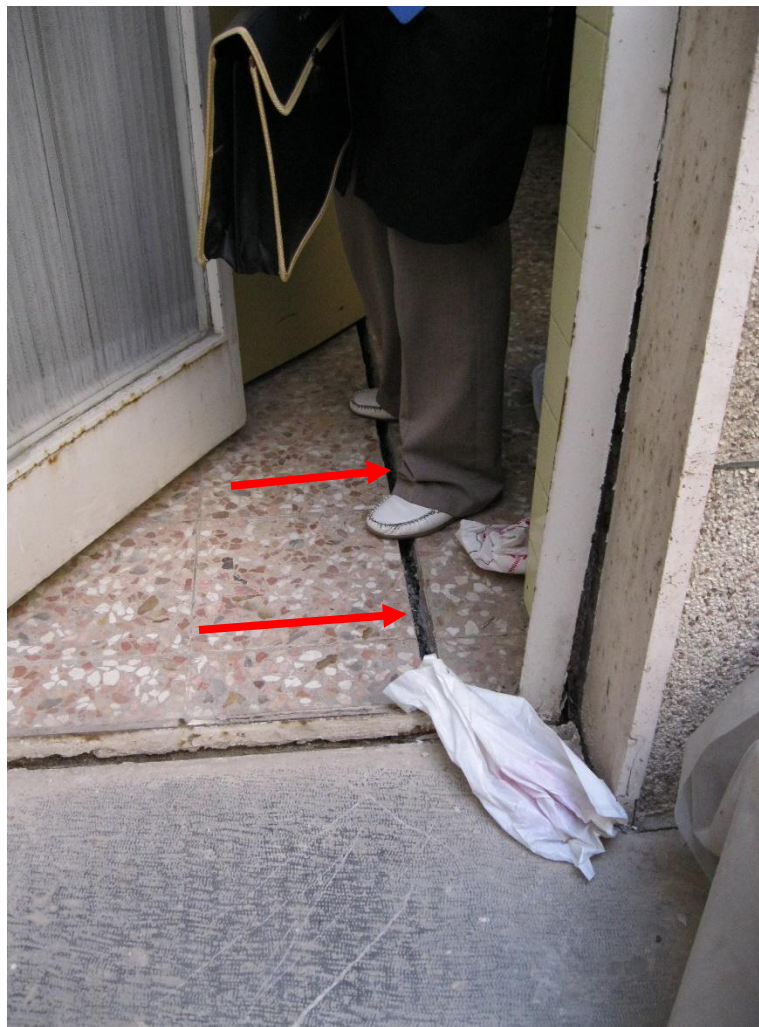
تصویر شماره 16 - ترک در کف ساختمان ، در اثر گود برداری در ملک مجاور
